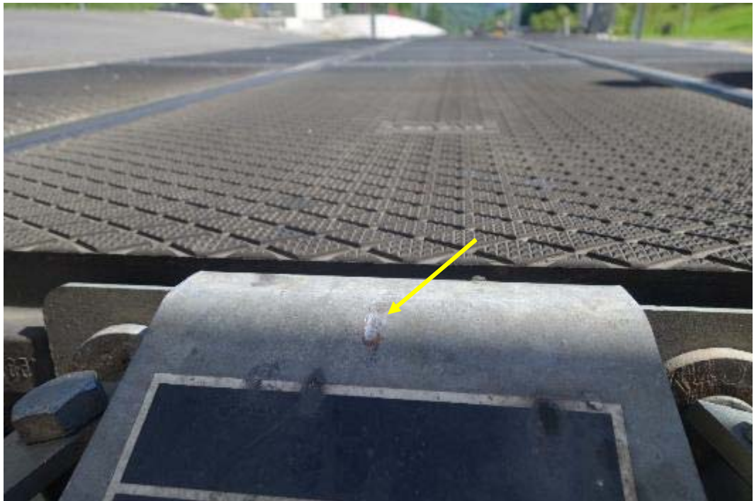
Abbildung 6: Anschlagspuren am Bahnübergang bei Grafenort (Pfeil).
