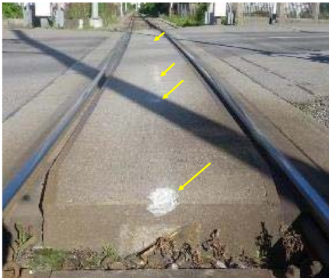
Abbildung 7: Anschlag- und Schleifspuren am Bahnübergang bei Stans (Pfeile).
